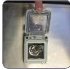
Der Schlüssel-Schalter ist im wasserfesten Kasten platziert.
