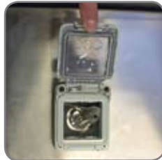
Der Schlüssel-Schalter ist im wasserfesten Kasten platziert.
